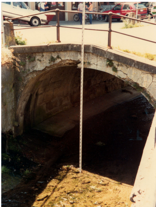
Abb. 41 (undat. vor 1987) Rösslibrücke Vorzustand Sanierung, von Osten her gesehen. Q: Walter Schwarz, Ingenieurbüro 8180 Bülach (1995, S. 2).
